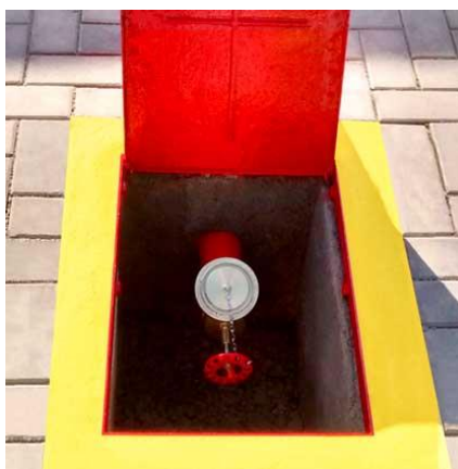
Dispositivo de recalque instalado no passeio
