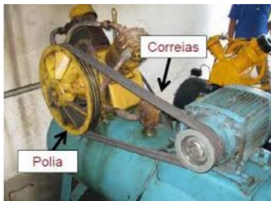
Figura 1.1: Sistema de transmissão de potência sem proteção 1
