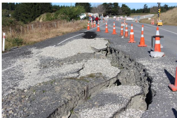
Figura 43: Exemplo de solo colapsível sob pavimento
