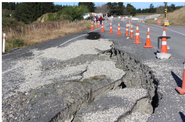
Figura 43: Exemplo de solo colapsível sob pavimento
