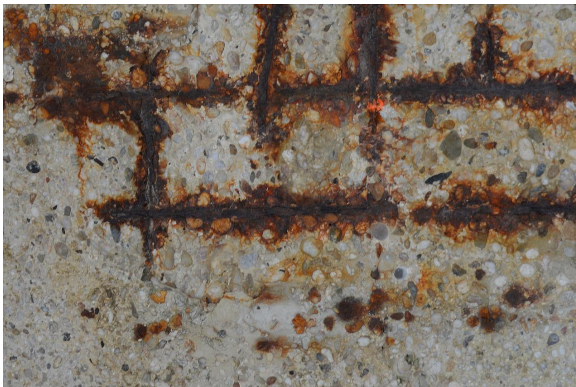
Figura 18: a falta de cobertura da armadura prejudica a vida útil da estrutura
