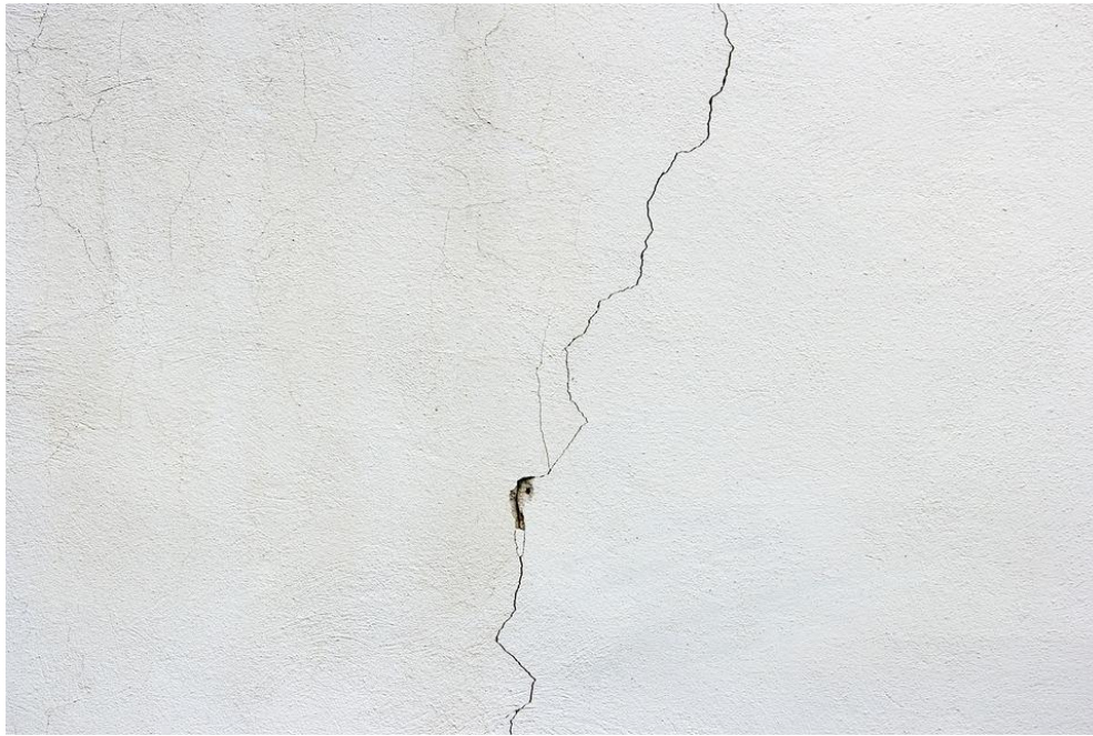
Figura 41: nem sempre uma trinca no concreto indica ruptura da estrutura por tração
