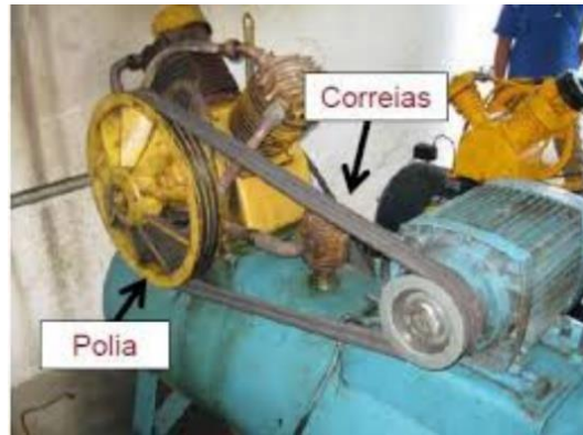
Figura 1.1: Sistema de transmissão de potência sem proteção 1
