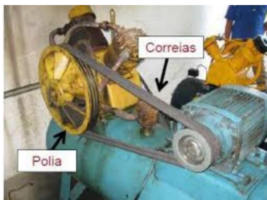
Figura 1.1: Sistema de transmissão de potência sem proteção 1
