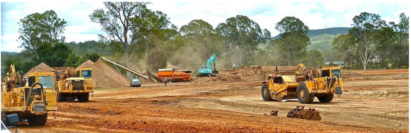
Figura 1: os equipamentos devem trabalhar juntos, coordenados, cada um com sua meta buscando o cumprimento do cronograma da obra
