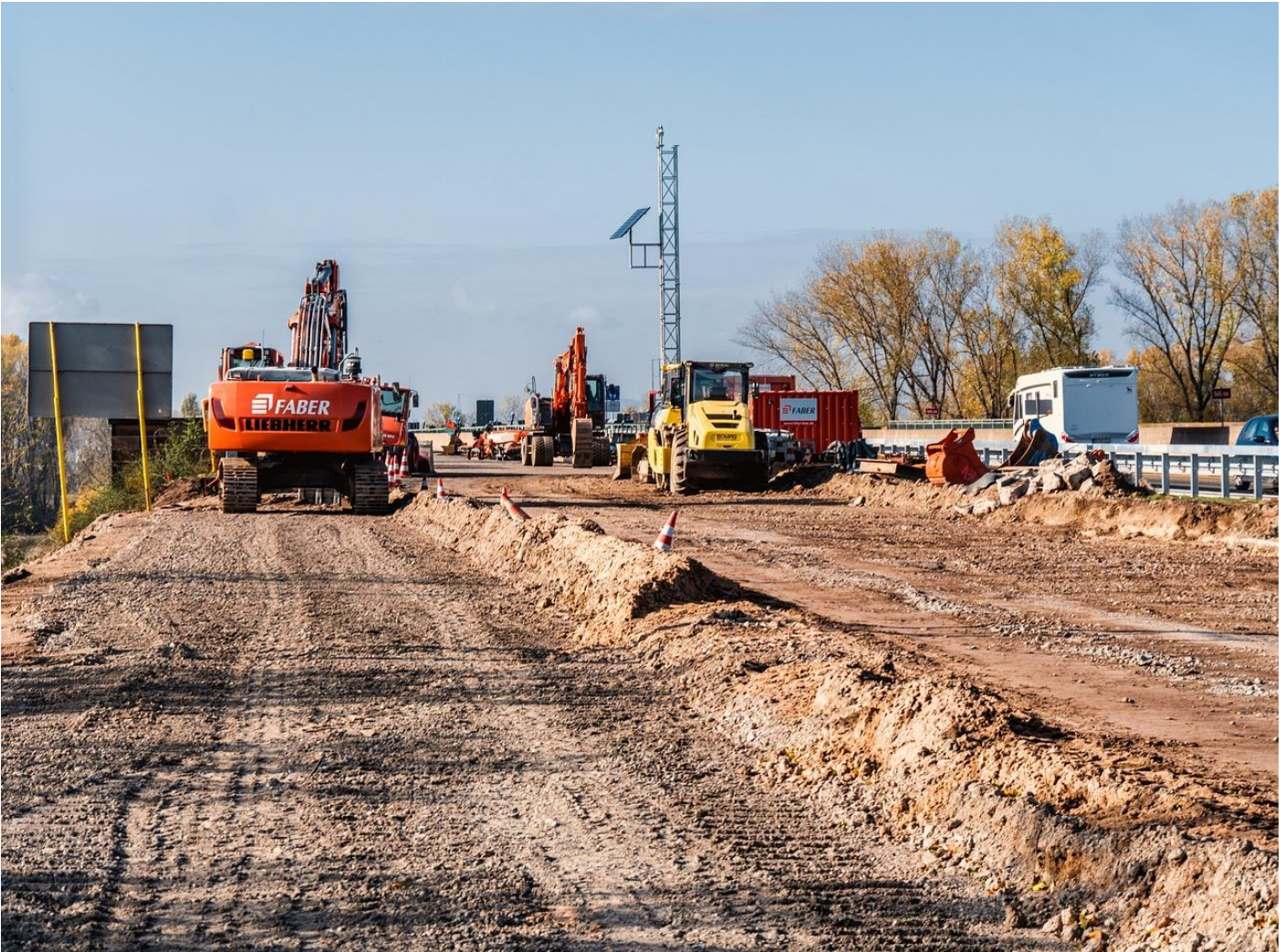
Figura 39: é somente a partir da conclusão de uma rodovia que os veículos conseguem transitar por ela, sendo necessário para o usuário que não somente a terraplanagem, mas toda a pavimentação sejam concluídos em 100%
