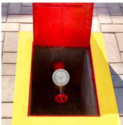
Dispositivo de recalque instalado no passeio
