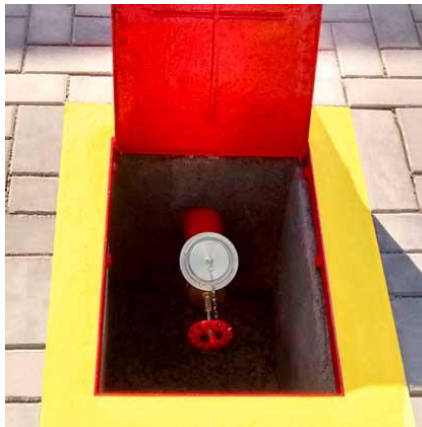
Dispositivo de recalque instalado no passeio
