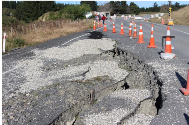
Figura 43: Exemplo de solo colapsível sob pavimento
