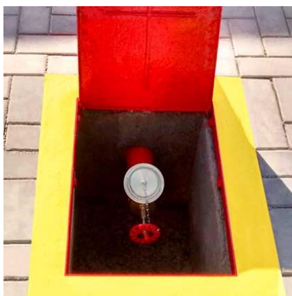
Dispositivo de recalque instalado no passeio
