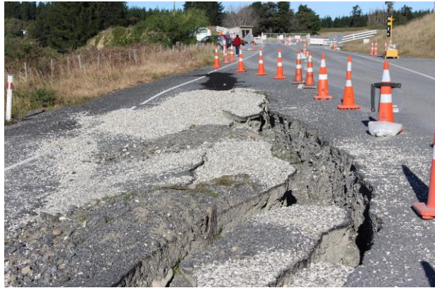
Figura 43: Exemplo de solo colapsível sob pavimento
