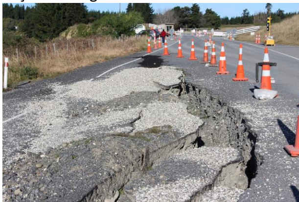
Figura 39: Exemplo de solo colapsível sob pavimento
