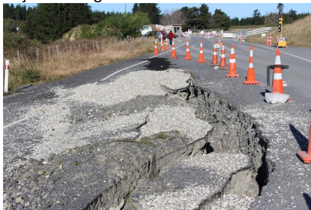
Figura 36: Exemplo de solo colapsível sob pavimento
