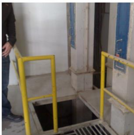
Abertura no piso, sem proteção
