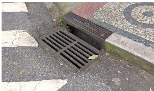
Figura 59: Exemplo de boca de lobo combinada com abertura lateral e também grelha horizontal
