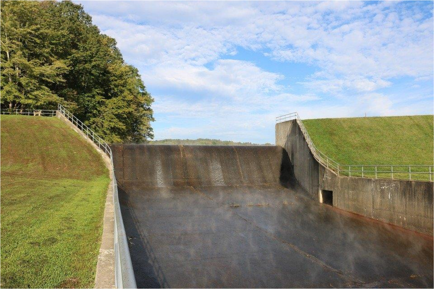
Figura 43: vertedouros permitem o escoamento da água excedente em um reservatório
