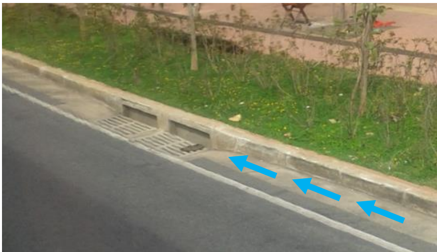
Figura 56: A boca de lobo coleta a água da sarjeta e envia para as galerias da rede de drenagem pluvial
