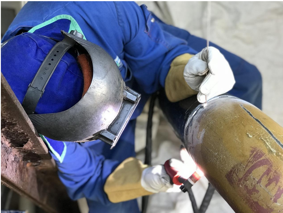
Figura 16: são comuns em obra os equipamentos alimentados por alta tensão
