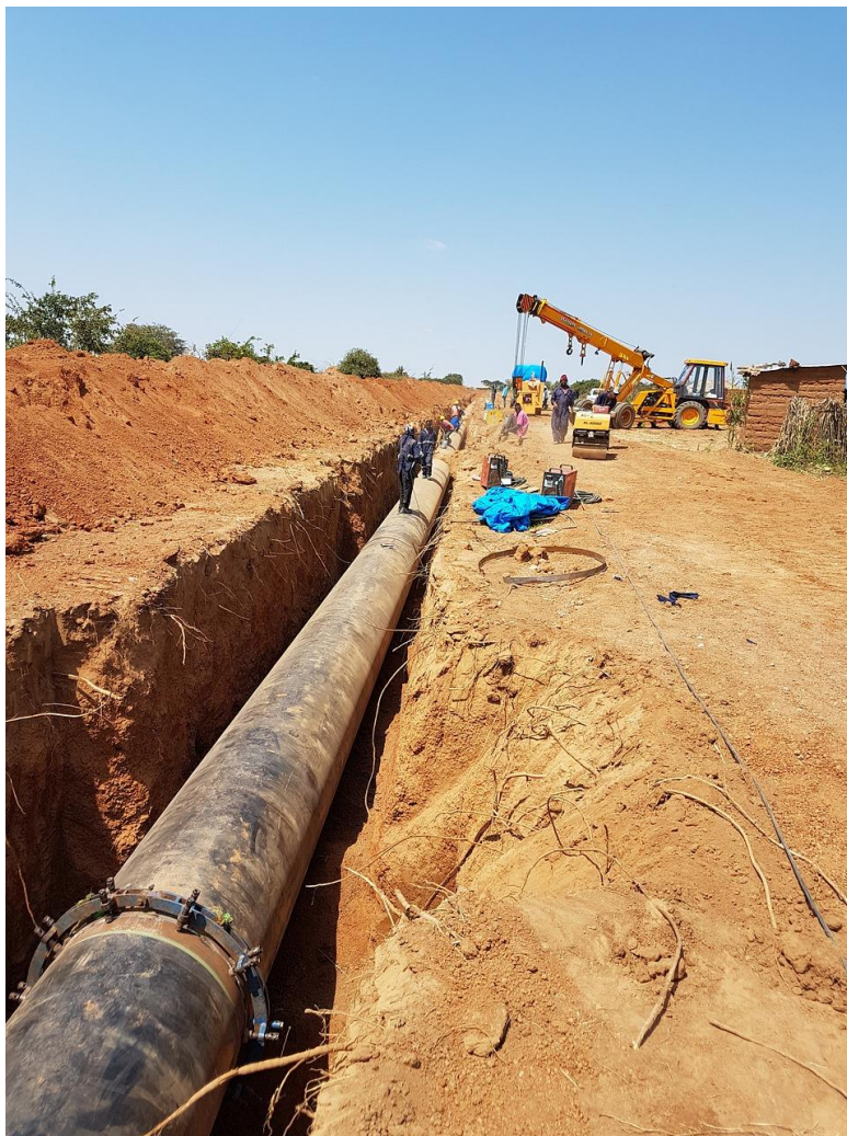
Figura 27: escavação com material depositado a 1 metro da borda
