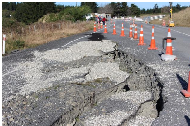
Figura 43: Exemplo de solo colapsível sob pavimento
