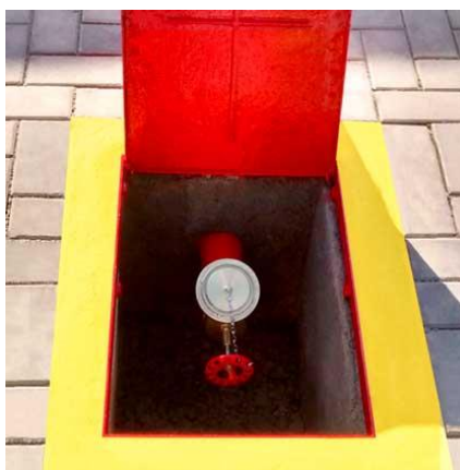
Dispositivo de recalque instalado no passeio
