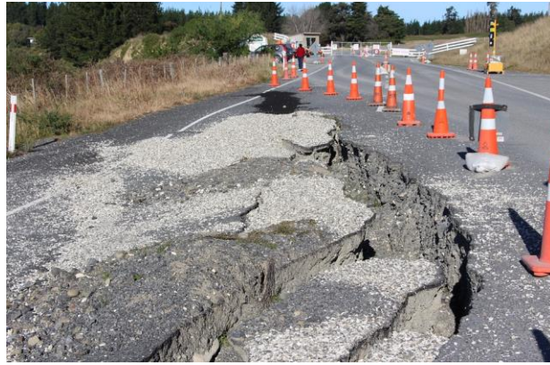
Figura 44: Exemplo de solo colapsível sob pavimento
