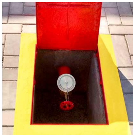
Dispositivo de recalque instalado no passeio
