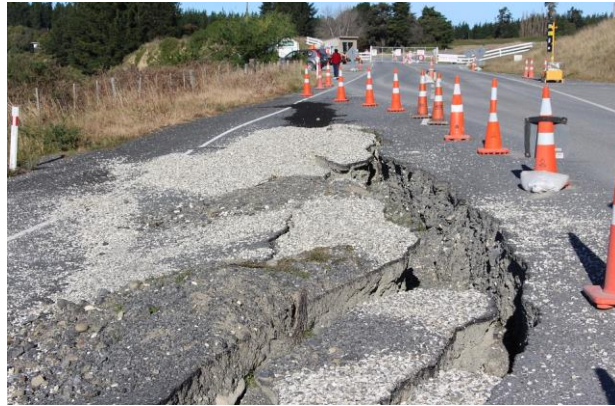
Figura 44: Exemplo de solo colapsível sob pavimento
