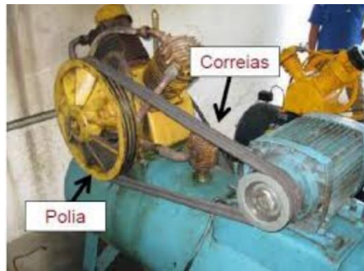
Figura 1.1: Sistema de transmissão de potência sem proteção 1
