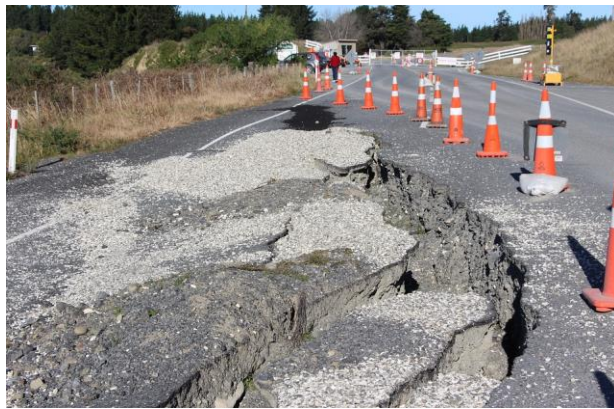
Figura 44: Exemplo de solo colapsível sob pavimento
