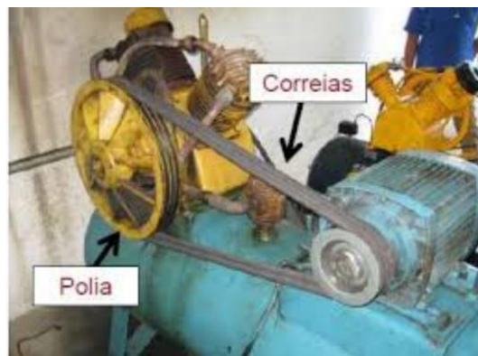
Figura 1.1: Sistema de transmissão de potência sem proteção 1
