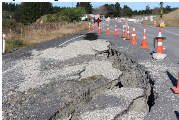
Figura 39: Exemplo de solo colapsível sob pavimento
