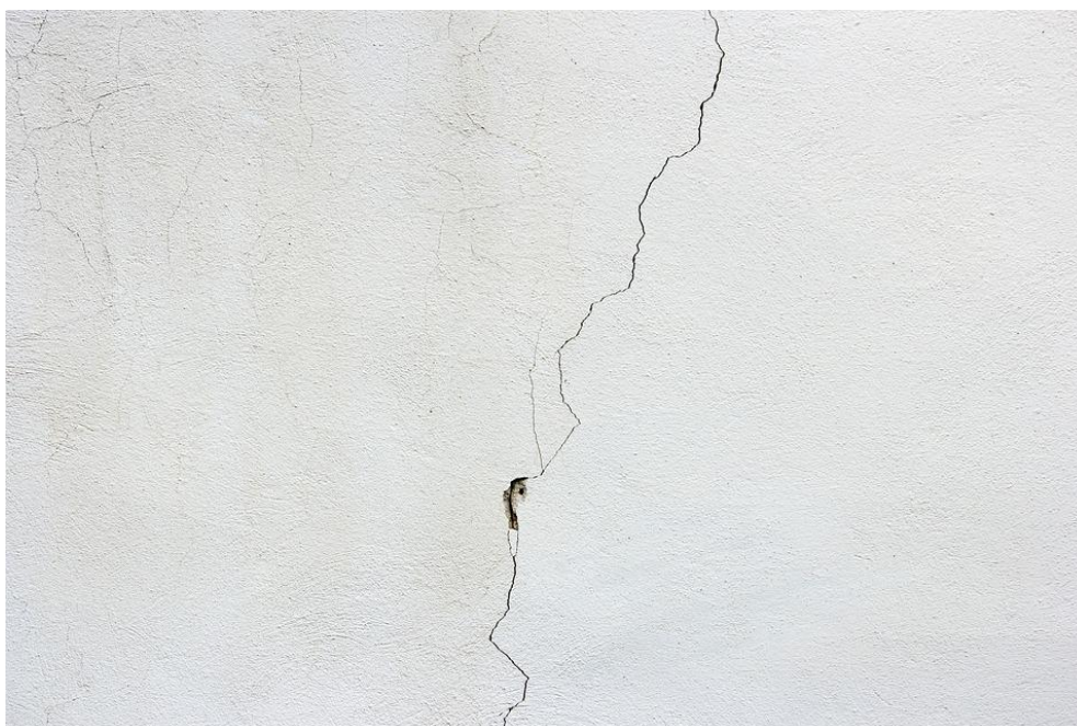
Figura 33: nem sempre uma trinca no concreto indica ruptura da estrutura por tração
