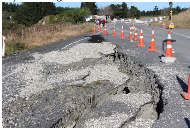
Figura 36: Exemplo de solo colapsível sob pavimento
