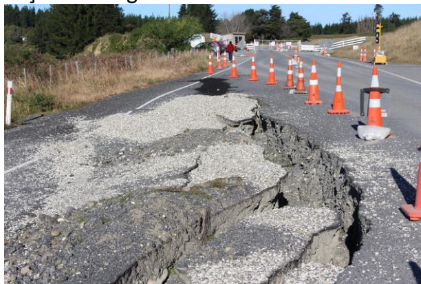
Figura 36: Exemplo de solo colapsível sob pavimento
