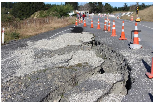
Figura 44: Exemplo de solo colapsível sob pavimento
