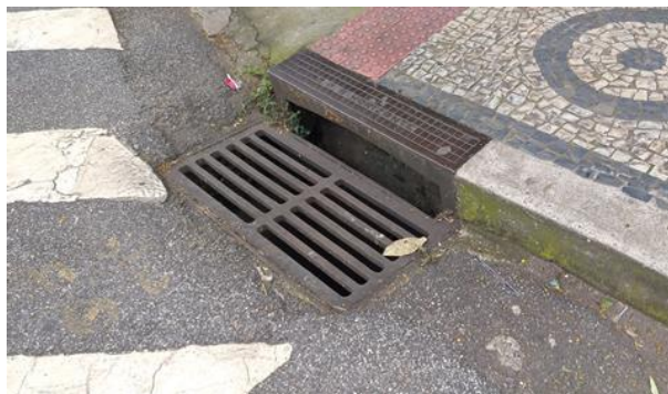
Figura 59: Exemplo de boca de lobo combinada com abertura lateral e também grelha horizontal
